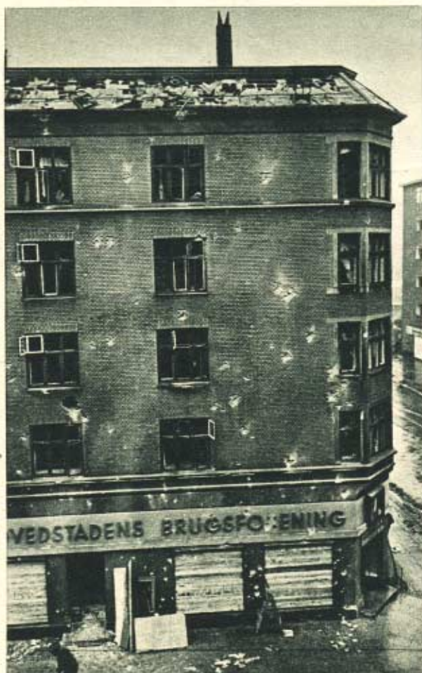
Bygning i Njalsgade i København efter Bombenedkastningen den 27. Januar 1943. Læg Mærke til, hvor Facaden er gennemhullet som en Si af talrige Sprængstykker efter den 225 kg Bombe, der eksploderede midt i Gaden
